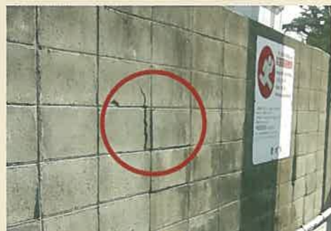
ブロック塀の劣化
