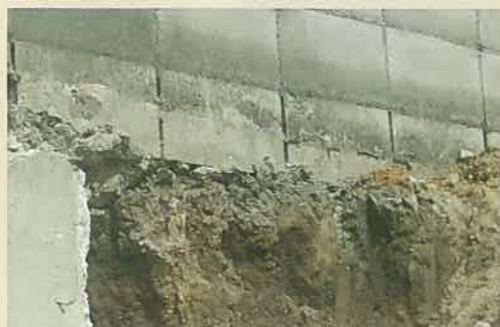
隣地、境界線では十分な基礎が取れない
