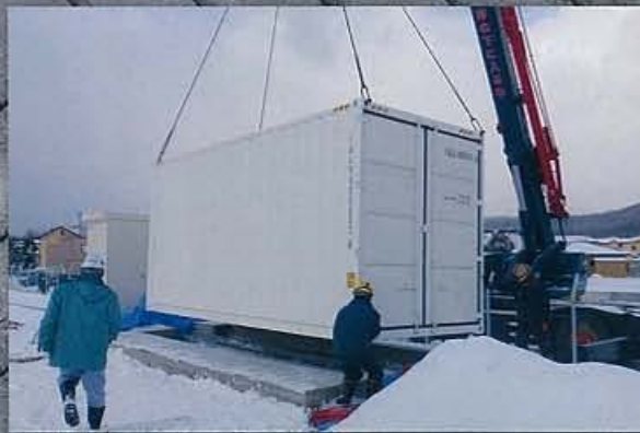
現地設置風景
